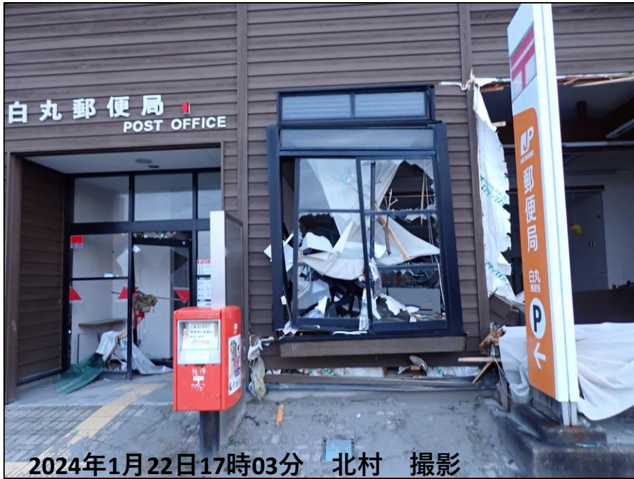
津波による ガラスの破壊
